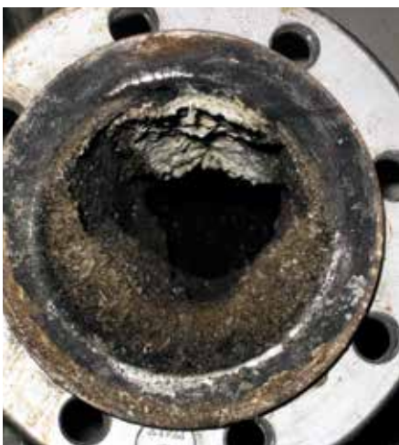
Εικόνα 4: Απόθεση στρουβίτη στη μονάδα επεξεργασίας υπολειμματος
